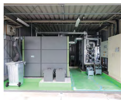
木質バイオマスボイラー
